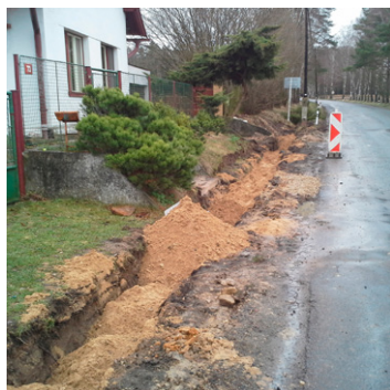
Dešťová kanalizace v Bělčce – před
