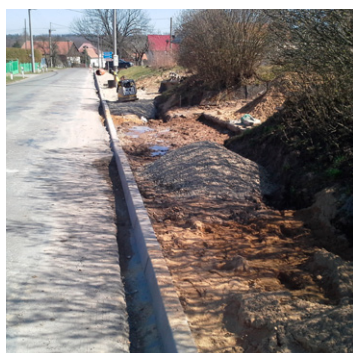
Dešťová kanalizace v Bělčce – před
